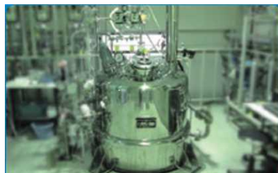
バイオマスプラスチック製造設備
