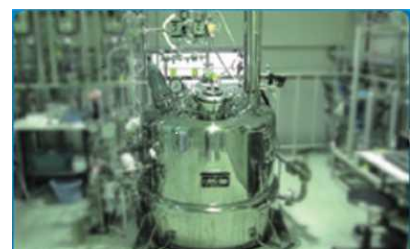
バイオマスプラスチック製造設備
