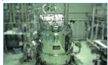
バイオマスプラスチック製造設備
